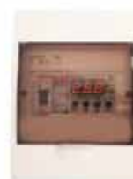
Quadro di controllo
