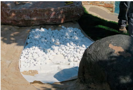
7. Stesura del telo in tessuto di protezione. 7. Laying of the non-woven protective cloth.
