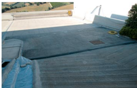
1. SOLAIO DI COPERTURA CARRABILE DA IMPERMEABILIZZARE SENZA DEMOLIRE
