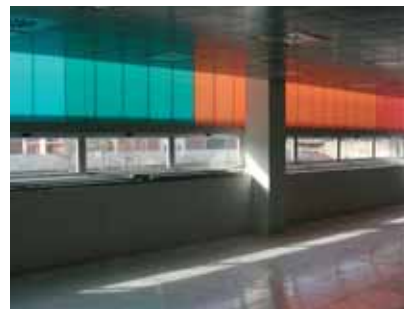
Il sistema di lastre Lexan Thermoclick è usato per la facciata di questo edificio a Barcellona.
